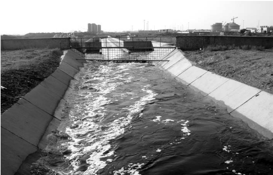
شکل شماره ۱-۳- کانال روبان انتقال پساب تصفیه خانه فاضلاب جنوب تهران
